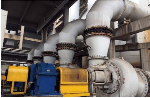
改造机组浆液循环泵
